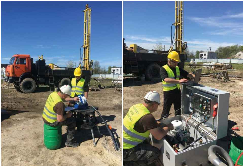
Ryc. 6. Profilowanie termiczne i badanie TRT otworowego wymiennika ciepła
